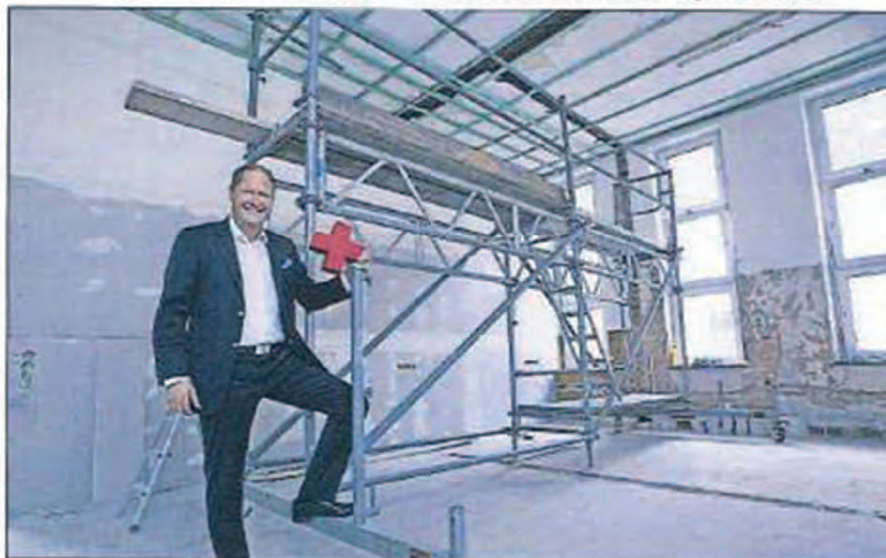
Komplett neu: DRK-Kreisgeschäftsführer Marco Prinz im großen Saal in der Augustastraße, der gerade von Grund auf saniert wird. FOTO: VIEW
